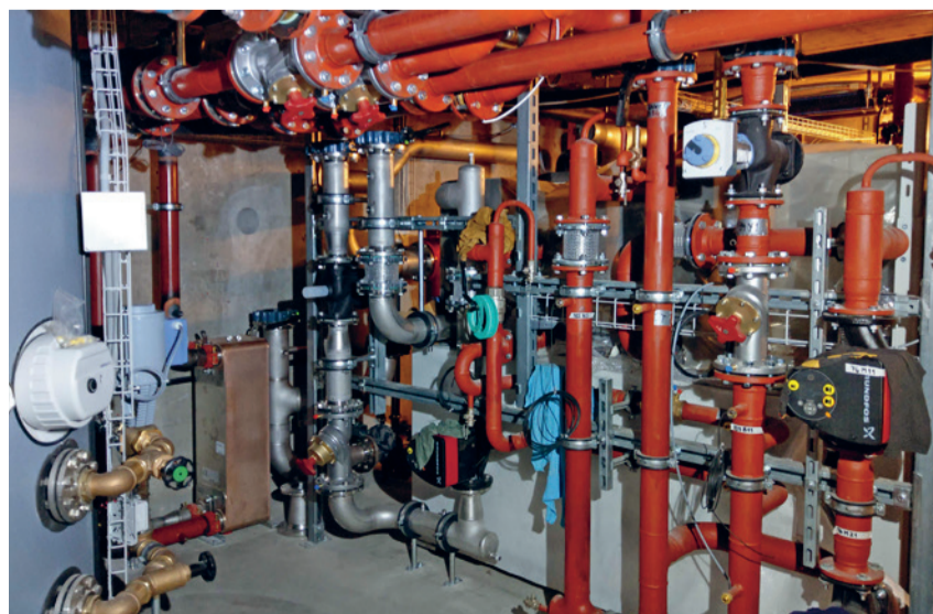
Röhrengewirr im Heizungskeller, hier der Vor- und Rücklauf der Heizung.
