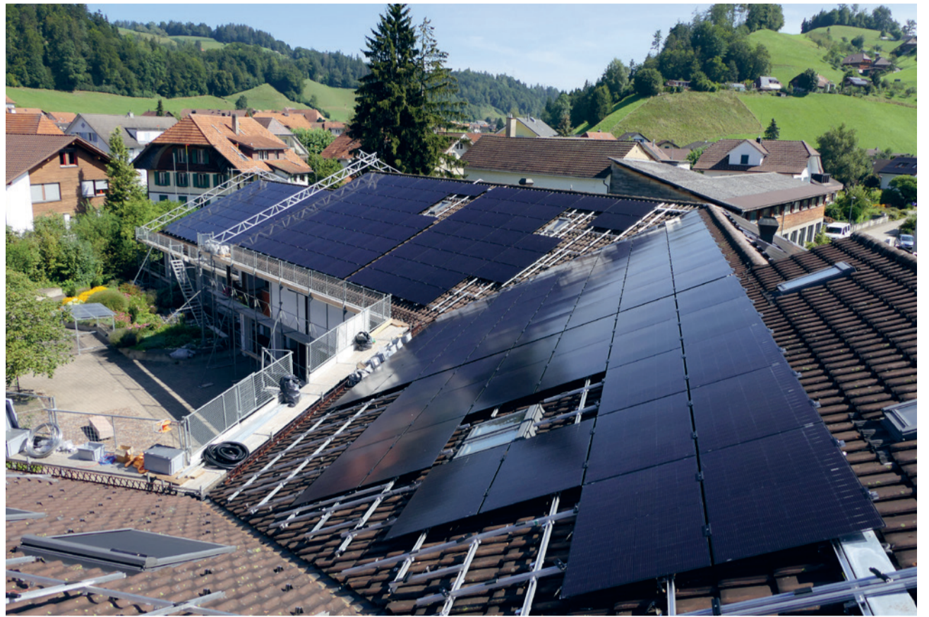
Die Fotovoltaikanlage besteht aus total 1053 Solar-Panels.
