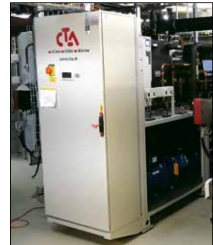
Die beiden Wärmepumpen erbringen eine Leistung von je 192 kW.
